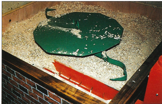
Störungsfreier Einsatz durch Verwendung von teurer Bunker-Austragung.
