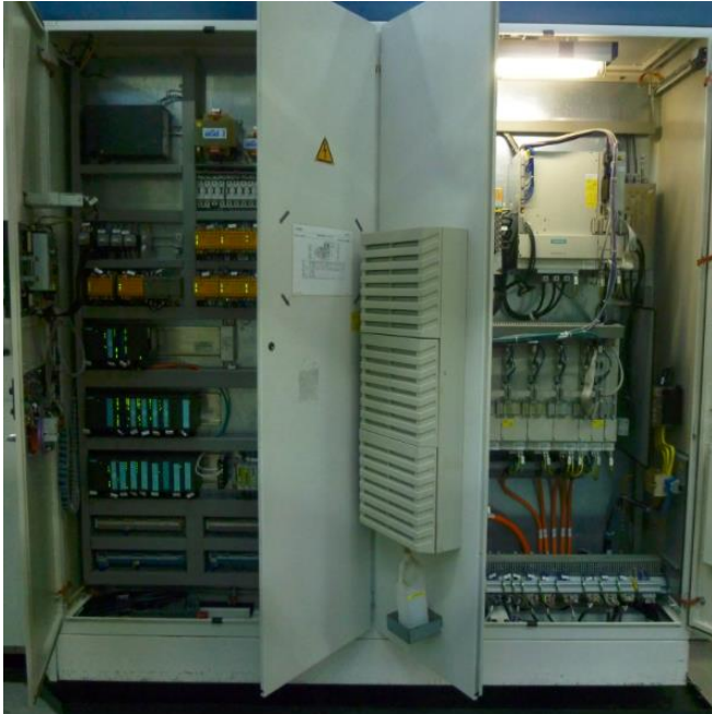
Schaltschrank offen (electrical cabinet open)
